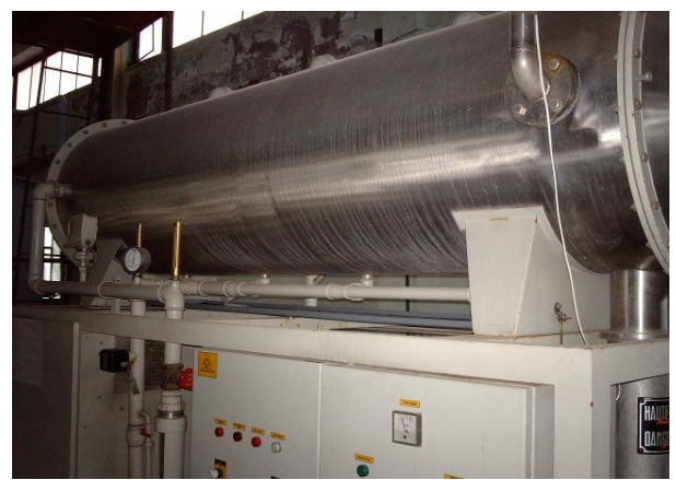
Instalație de ozon
