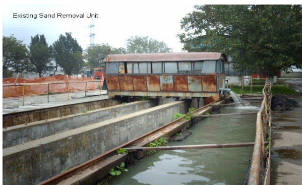
Figura Nr. 2-24 – Unitatea existentă de îndepărtare a nisipului
