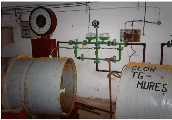
Stația de clorare
