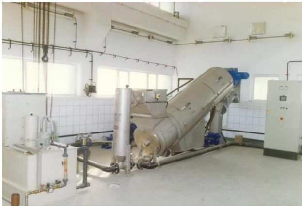
Figura Nr. 2-26 – Instalație mecanică de deshidratare
