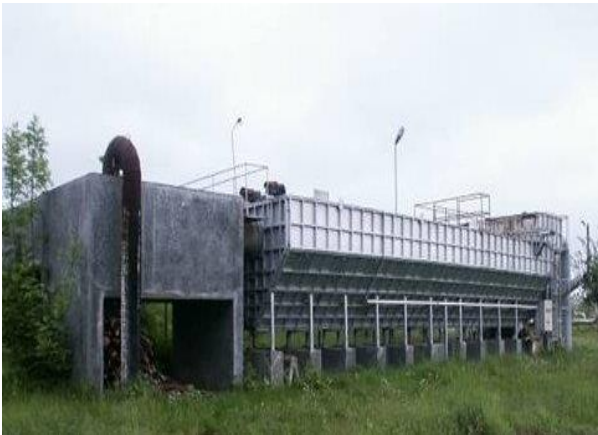
Figura Nr. 2-11 – Unitatea de îndepărtare nisip și grăsime
