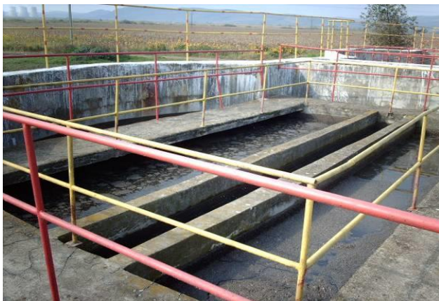
Figura Nr. 2-21 – Bazine de sedimentare canalizare
