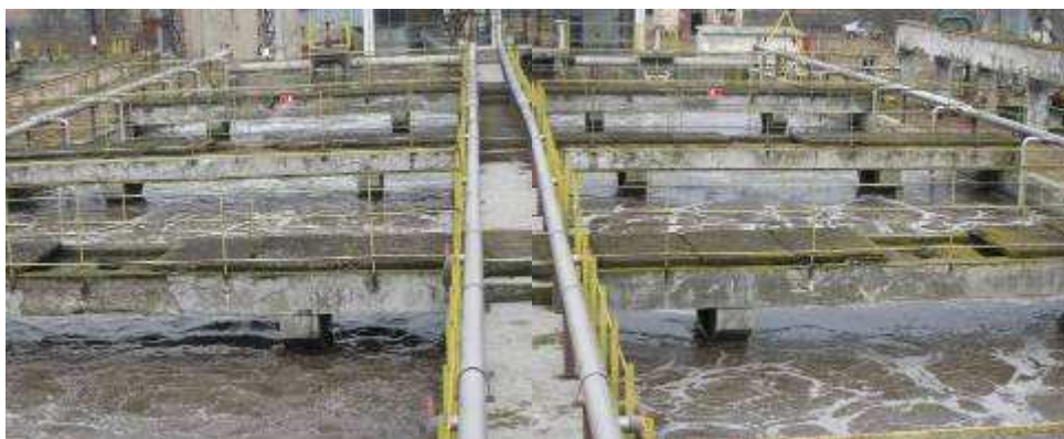
Figura 119 – Bazine de aerare SEAU Tarnaveni
