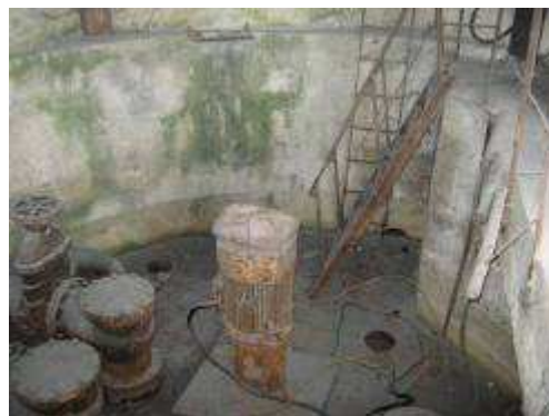
Figura 81 Statie pompare Reghin Figura 82
