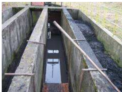
Figura 78 – Deznisipator SEAU Reghin
