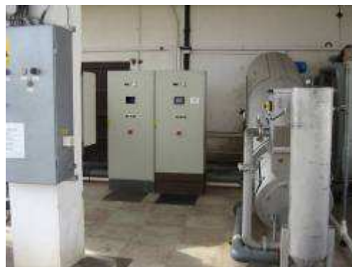
Figura 125 – Instalatie de prelucrare mecanica a namolului SEAU Tarnaveni
