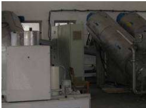
Figura 71 – Instalatiile de deshidratare SEAU Targu Mures
