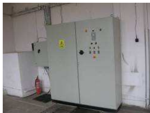
Figura 112 – Stație pompare apă uzată
