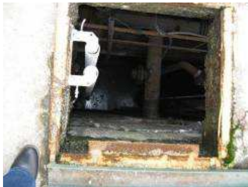
Figura 123 – Stație pompare nămol SEAU Tarnaveni
